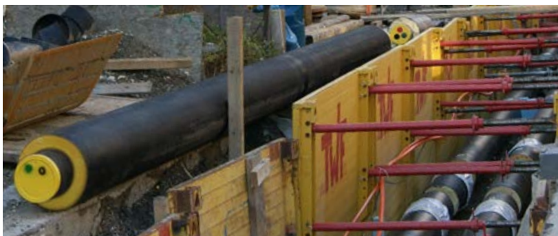
Die Fernwärmetransportschiene Innsbruck – Wattens sowie die Fernwärmeverteilnetze in Innsbruck, Volders und Völs werden laufend weiter ausgebaut.
